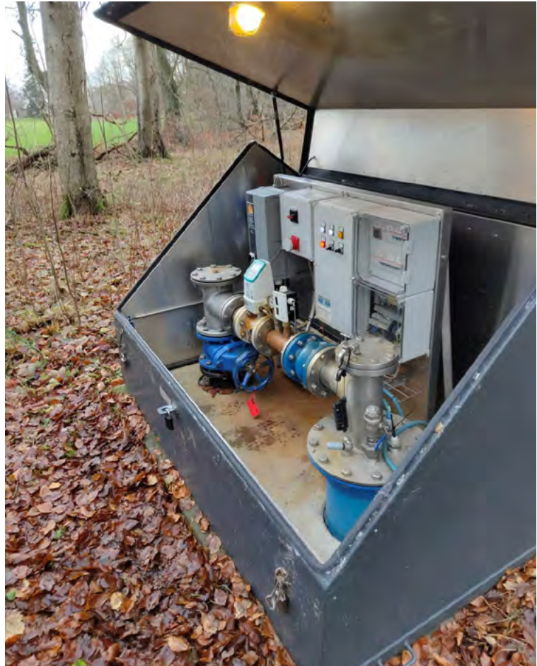
Hvis strømmen til vores boringer svigter, kan der slås over på nødgenerator.
