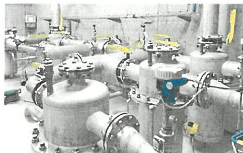
Maskinrum på Fornæs Renseanlæg.
